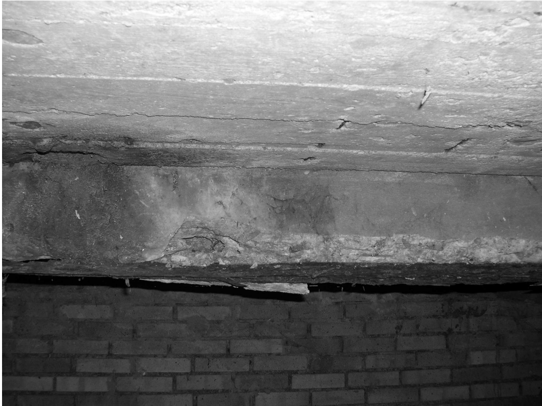
Obrázek 4 – poruchy železobetonového průvlaku a desky
