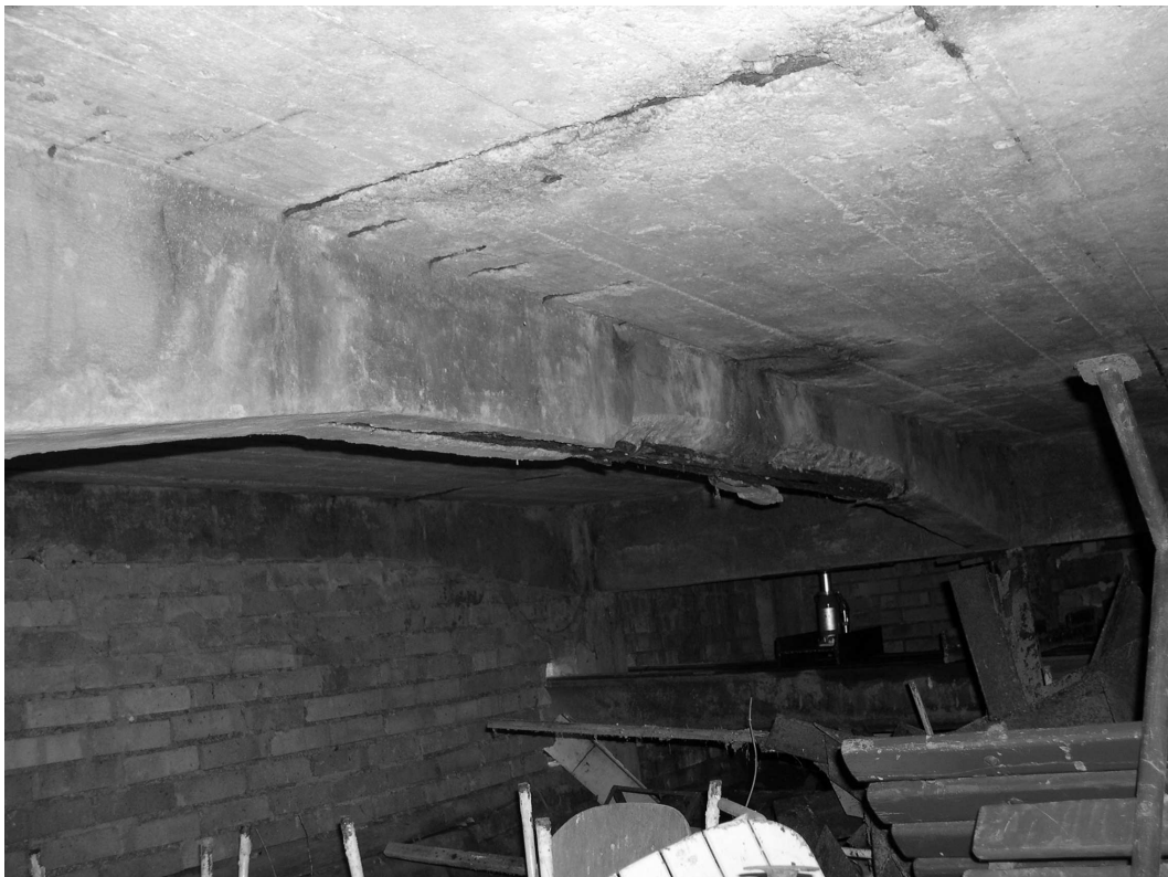
Obrázek 5 – poruchy železobetonového průvlaku a desky
