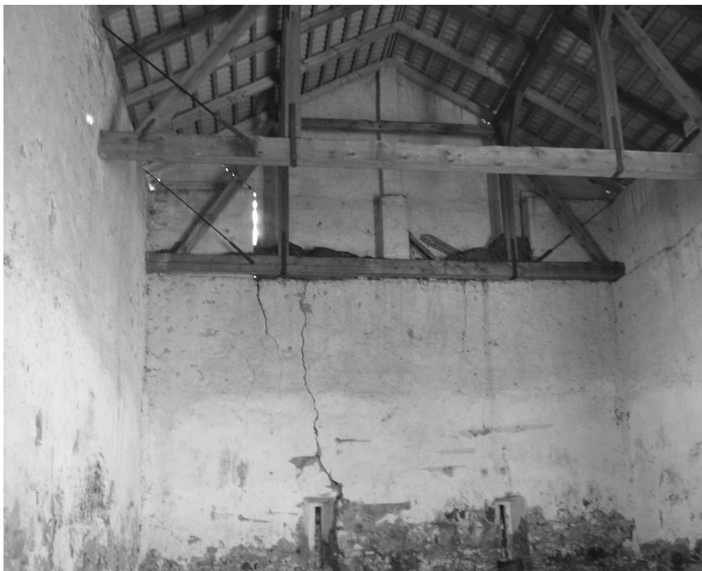
Obrázek 2 - Fotografie poruch zdiva objektu.
