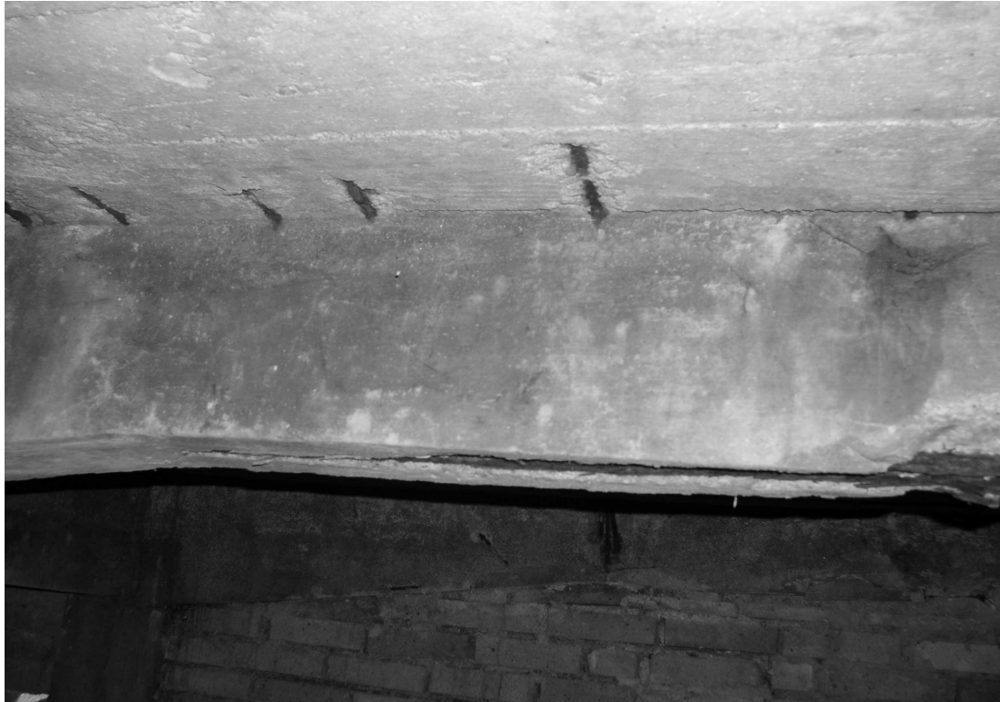
Obrázek 4 - Fotografie degradace výztuže železobetonu.
